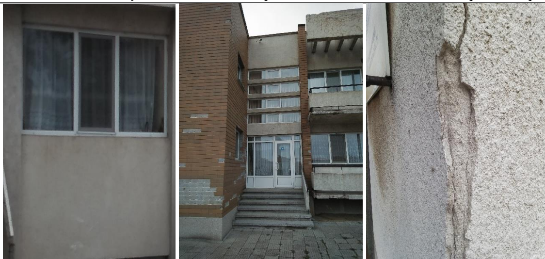
Фиг.1.6. Състояние на външни стени
