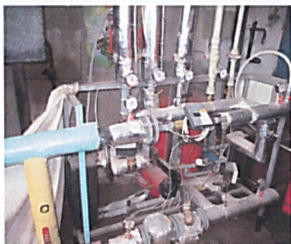
Фиг12. Абонатна станция
